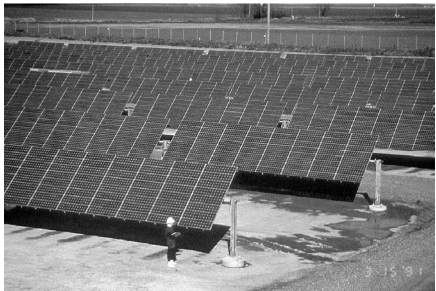
FIGURA 2-20 Paneles solares de la compañía Davis California Pacific Gas & Electric PVUSA (siglas en inglés de Celdas Fotovoltaicas para Aplicaciones a Gran Escala). Los paneles solares producen cd, la cual se convierte a ca antes de ser alimentada al sistema de ca. Esta planta produce 174 kilowatts. (Cortesía de Shell Solar Industries, Camarillo, California.)
